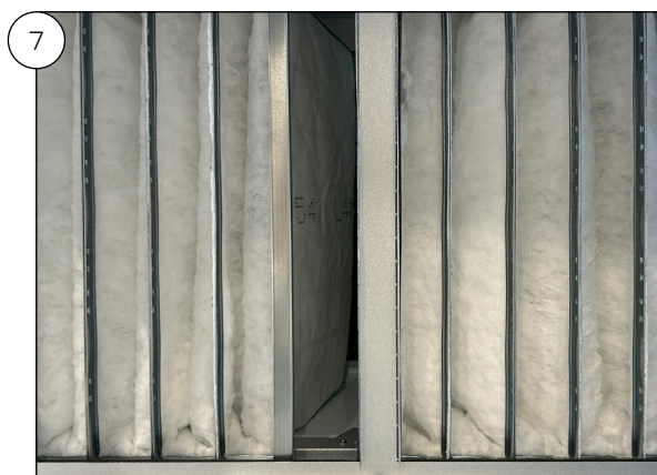
Vérifier qu'il n'y a pas d'espaces ni de fuites entre les filtres.
